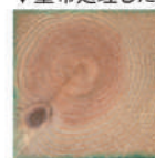
木材の表面のみ浅く浸透している
