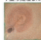
木材の表面のみ浅く浸透している
